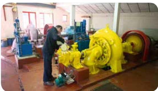
▷ Turbines Francis à l'Abbaye Sainte-Marie de la Pierre-qui-Vire – Saint-Léger-Vauban (89)
