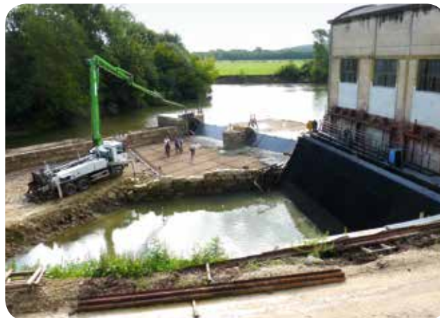
▷ 838 000 € HT investis pour réhabiliter une usine hydroélectrique à l'abandon depuis 30 ans - Centrale de Ray-sur-Saône (70)
