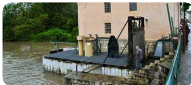
▷ Groupe immergé - Centrale de Scey-sur-Saône (70)
