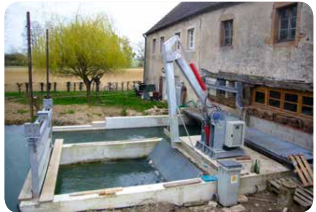
▷ Prise d'eau et dégrilleur automatique - Centrale de Tart-l'Abbaye (21)
