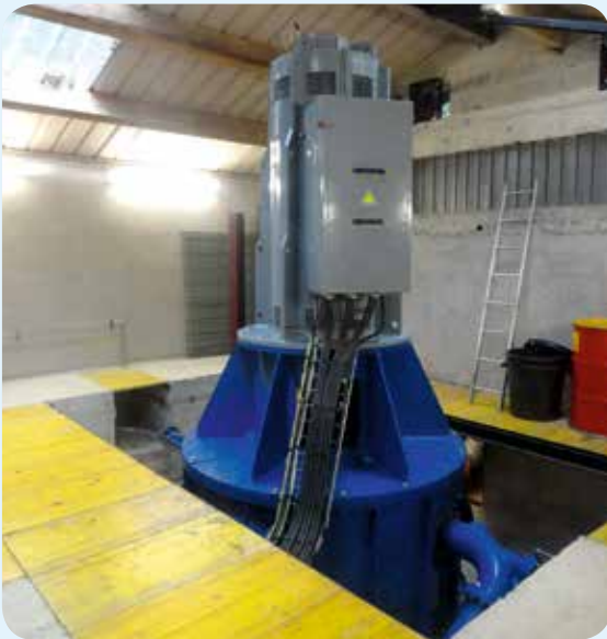
▷ Génératrice avec turbine Pelton sous conduite forcée et 126 m de dénivelé - Centrale du Gour - Laissey (25)
