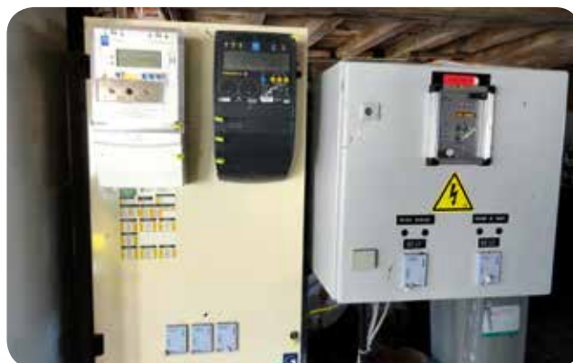
▷ Compteurs et coffret de découplage réseau – Moulin de Tart-l'Abbaye (21)
