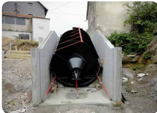
▷ Vis hydrodynamique en phase travaux Champdôtre (21)
