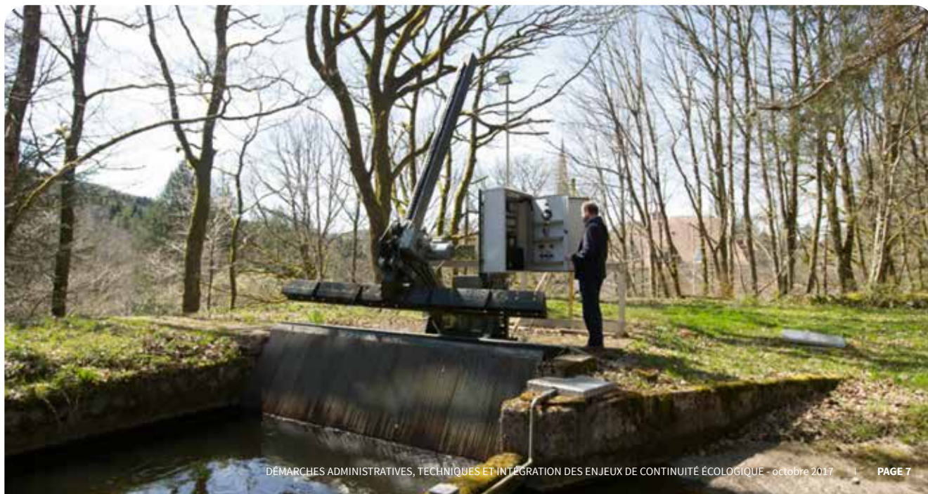
▷ Prise d'eau de l'installation de l'Abbaye Sainte-Marie de la Pierre-qui-Vire – Saint-Léger-Vauban (89)
