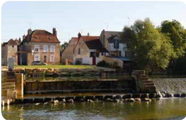
▷ Clapet de décharge et chasse des sédiments - Briénon-sur-Armançon (89)
