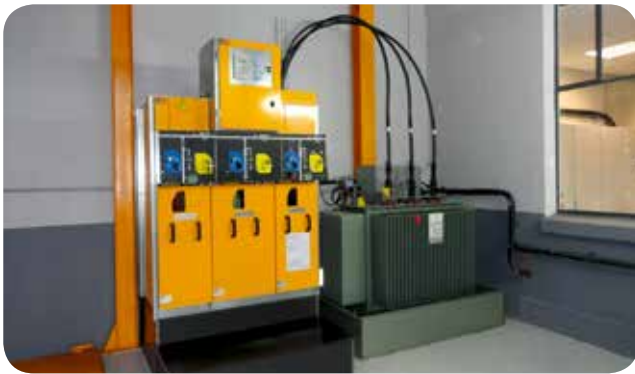
▷ Centrale de Ray-sur-Saône (70) : cellules HTA et transformateur
