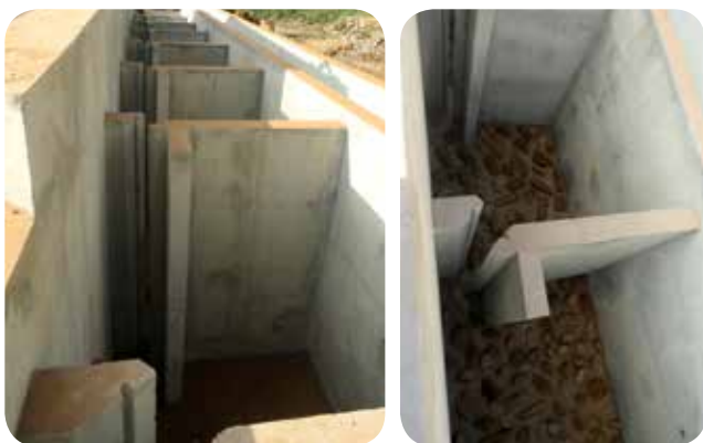
▷ Passe à poissons - Briénon-sur-Armançon (89)
